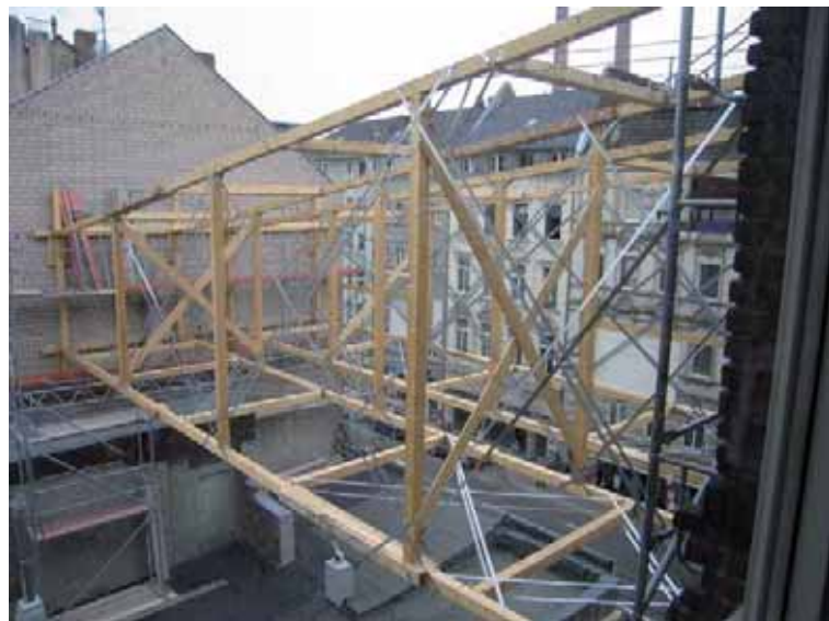
Abb. 14: Giebelabstützung zwischen zwei Häusern an der Bonner Straße
