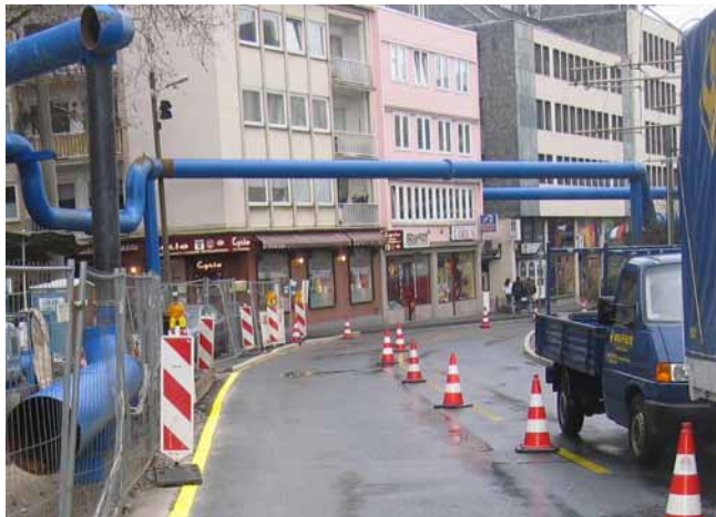
Abb. 5: Grundwasserrohre in der Augustinerstraße
