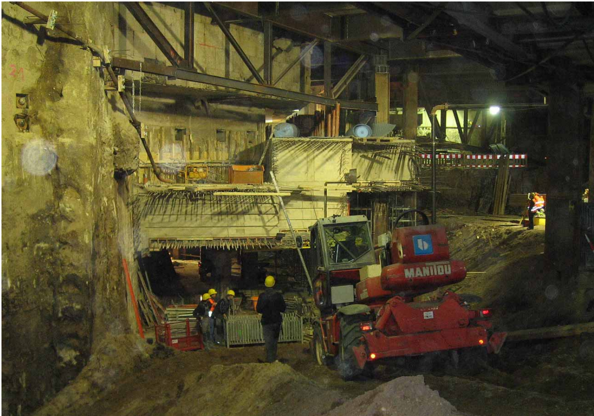
Abb. 5: Überstehende Ecke des Hotels InterContinental Köln
